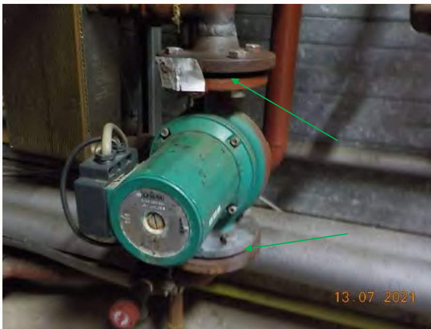
Foto 14: Bron B05, asbestvrije pakkingen tussen flenzen cv ruimte
