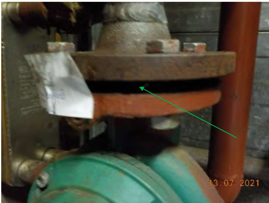
Foto 15: Bron B05, asbestvrije pakkingen tussen flenzen cv ruimte
