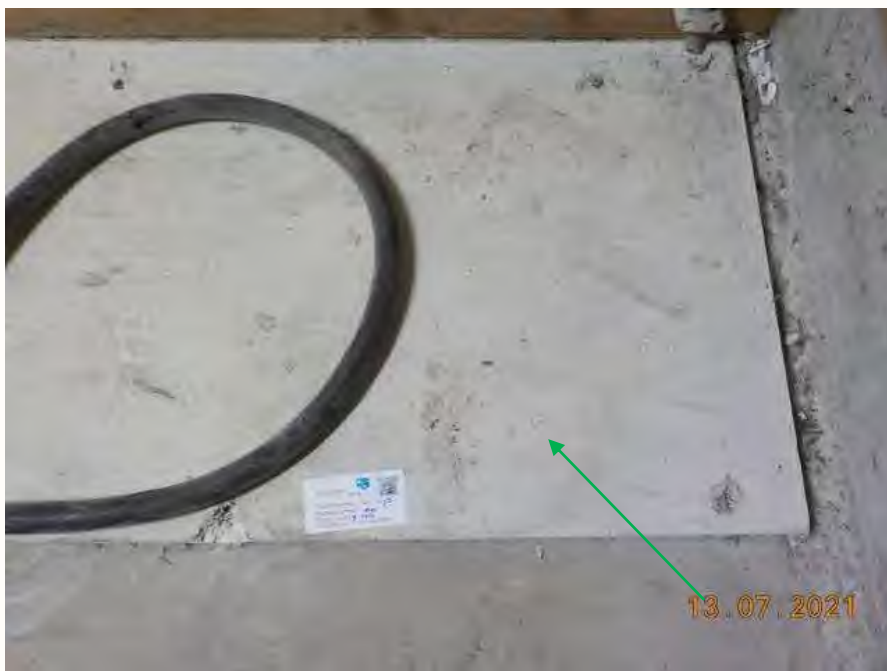
Foto 3: Bron B02, Asbestvrije beplating, cv ruimte
