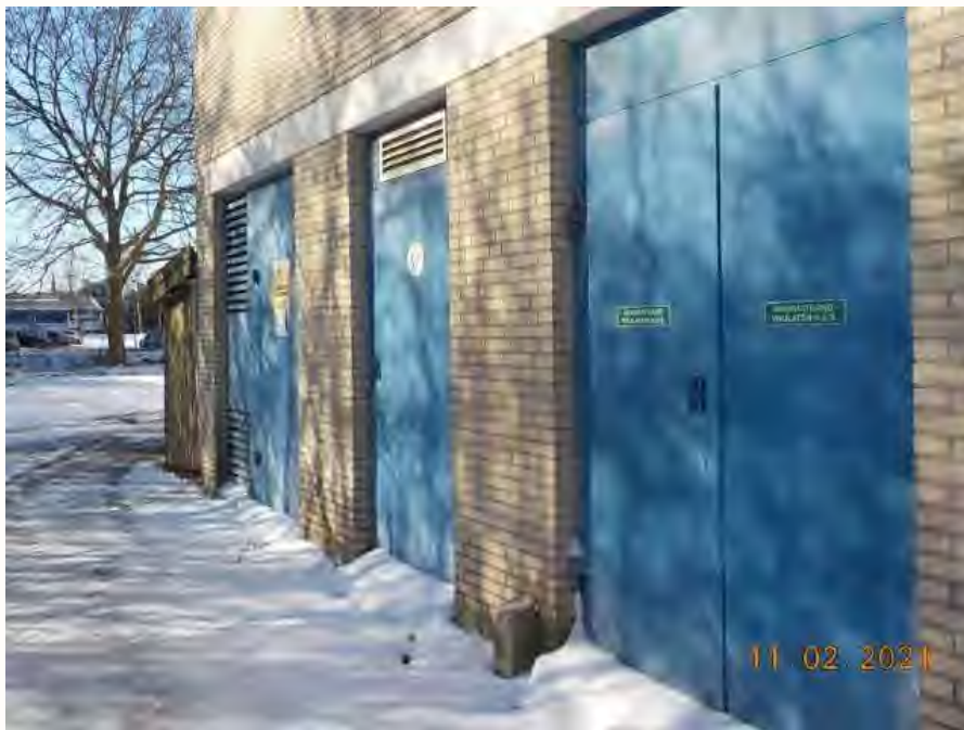
Foto 25: Hoogspanningsruimte, Noodstroom in beheer van Liander
