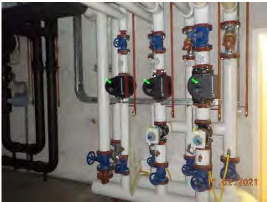
Foto 7: Bron B03, asbestvrije pakkingen
