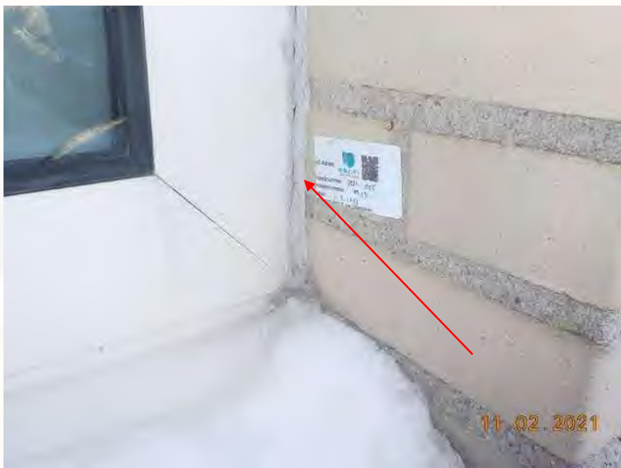
Foto 6: Bron B02, asbesthoudende kit langs aluminium kozijnen met metselwerk
