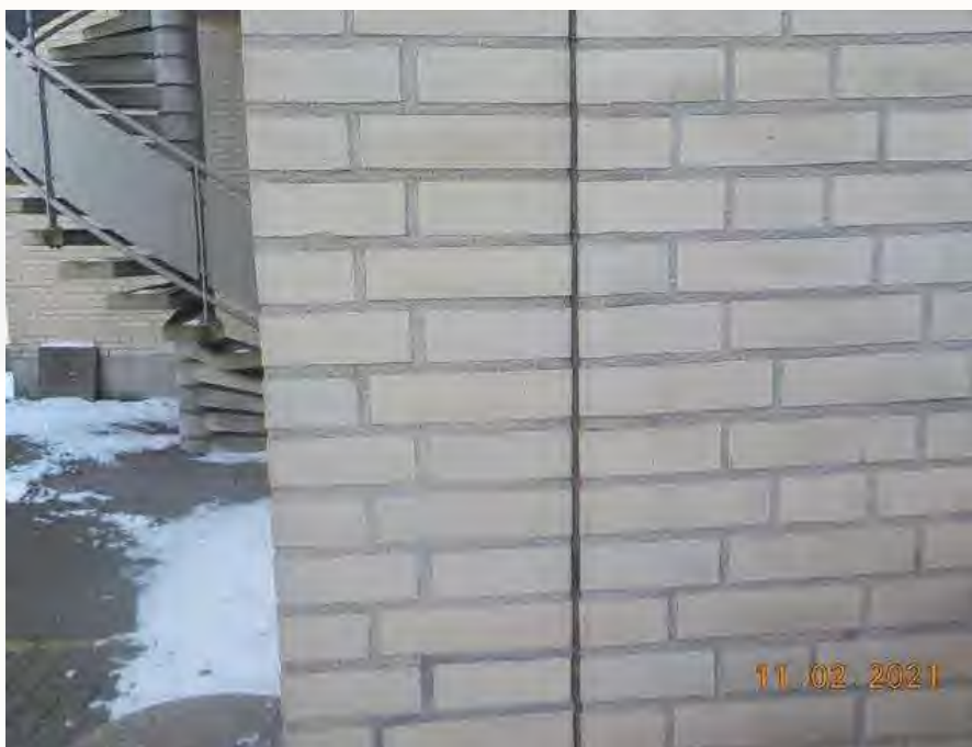
Foto 22: Bron B11, asbestvrije dilatatievoeg, kit
