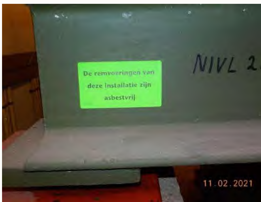
Foto 24: asbestvrije remvoeringen liftinstallatie
