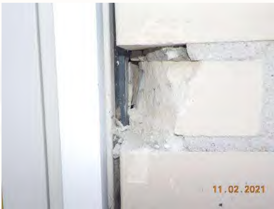
Foto 20: Bron B10, asbestvrije bitumen slab in spouwmuur
