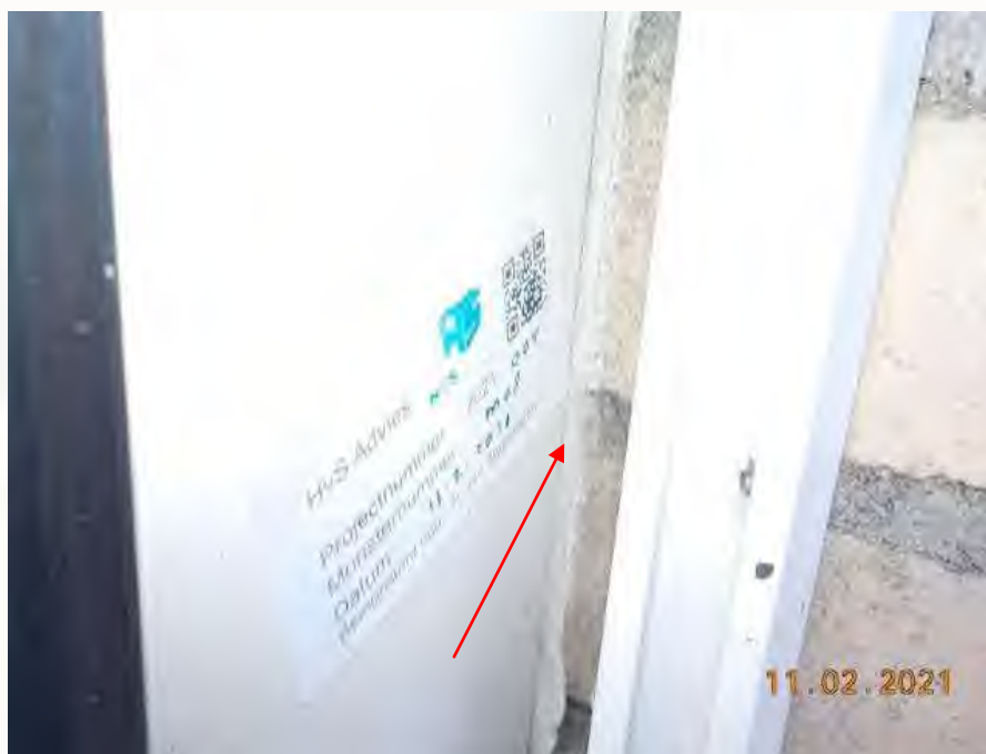
Foto 4: Bron B02, asbesthoudende kit langs aluminium kozijnen met metselwerk
