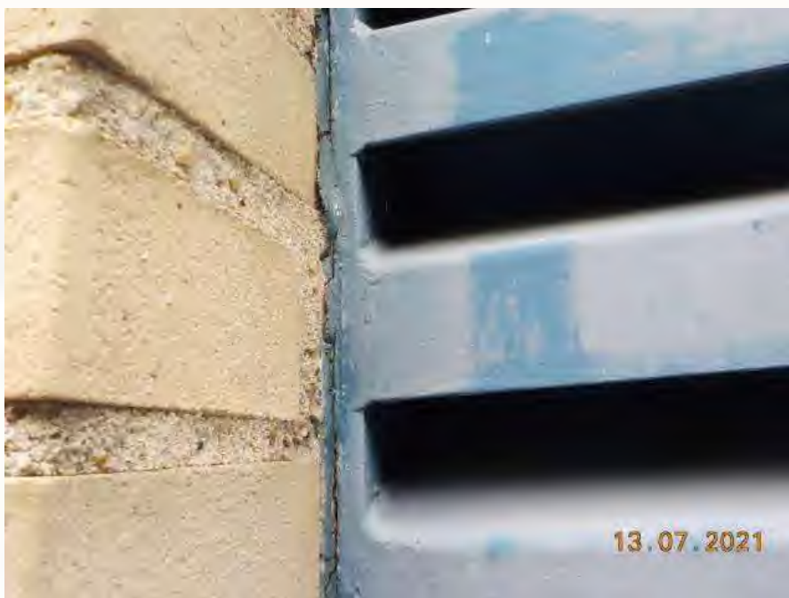
Foto 28: B02, asbesthoudende kit langs kozijnen hoogspanning met metselwerk
