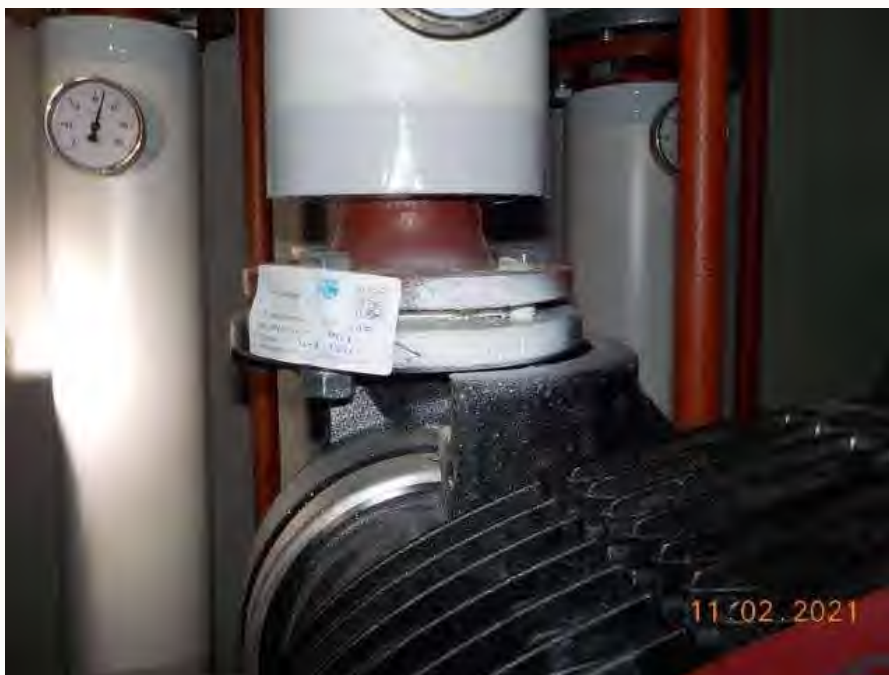
Foto 8: Bron B03, asbestvrije pakkingen
